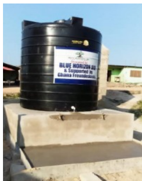
Tank mit Fundament
