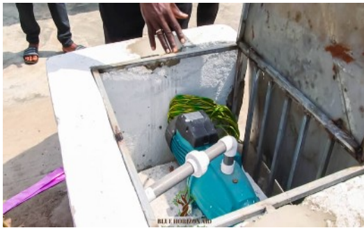
die neue Pumpe ersetzt den Eimer
